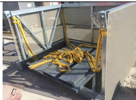
Photo 4 : Balcon en cours de manutention pour être posé sur la file de droite au 3 étage au moment de l'accident
