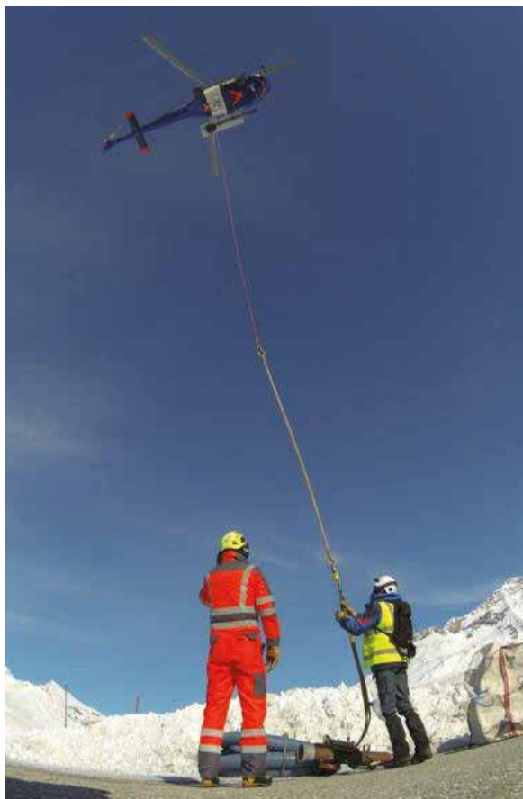
Le chef de manœuvre porte une tenue de couleur vive, facilitant son identification; il est placé à côté du helper et donc bien visible du pilote toujours assis sur le siège droit de l'hélicoptère. Il est en liaison radio avec le pilote.
